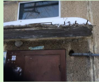
Разрушение козырька над входом
