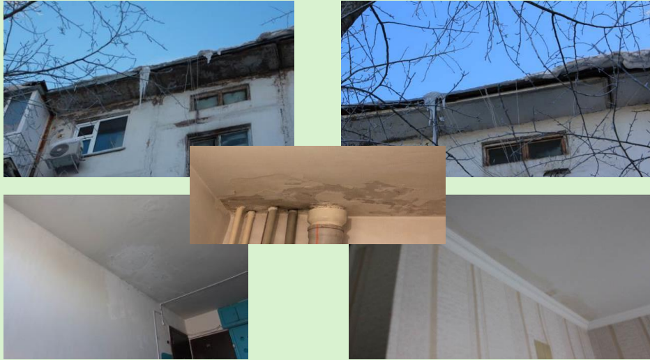
Отсутствие водостока, нарушение гидроизоляции кровли
