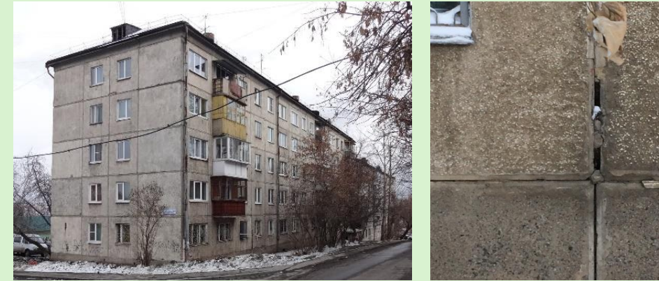
Отслоение, выпадение раствора из стыков В межпанельных швах
