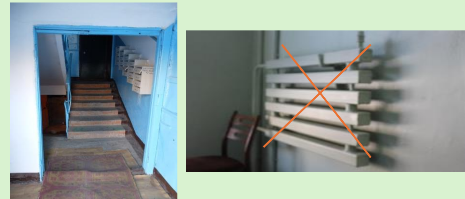
Отсутствие тамбура и холодные неотапливаемые подъезды
