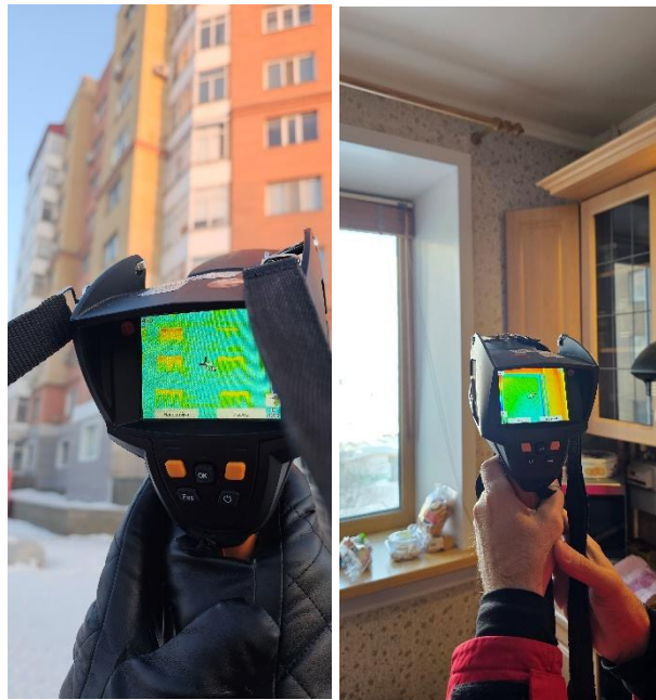
Тепловизионная съемка ограждающих конструкций дома: стены, окна, двери, кровля и проблемные зоны. © KazGBC
